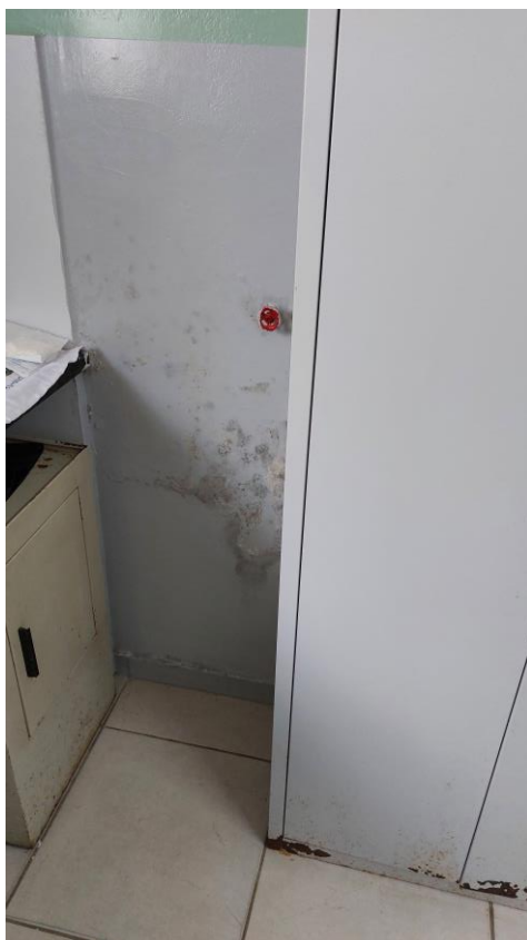
Infiltrações no prédio
